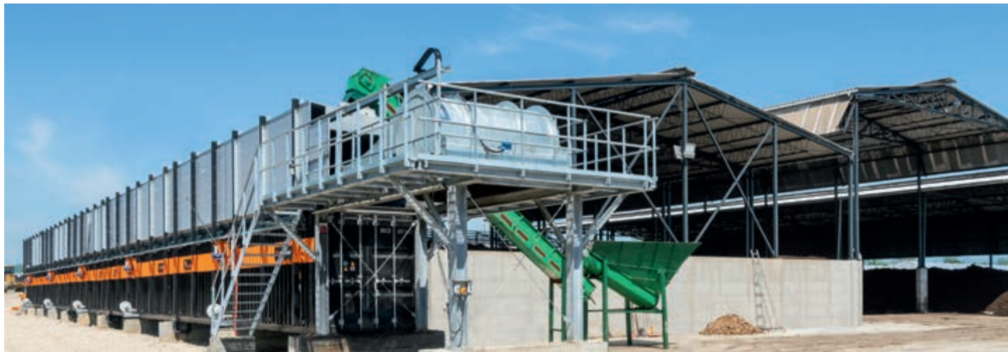
CompoLiner – Blick auf die Befüllseite und die Wartungsposition des Umsetzers
