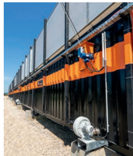
Kompressor leitet Frischluft in das zu kompostierende Material
