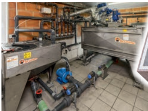
Futterküche: 1-Tank-Anlage mit gewogenem Brauchwassertank
