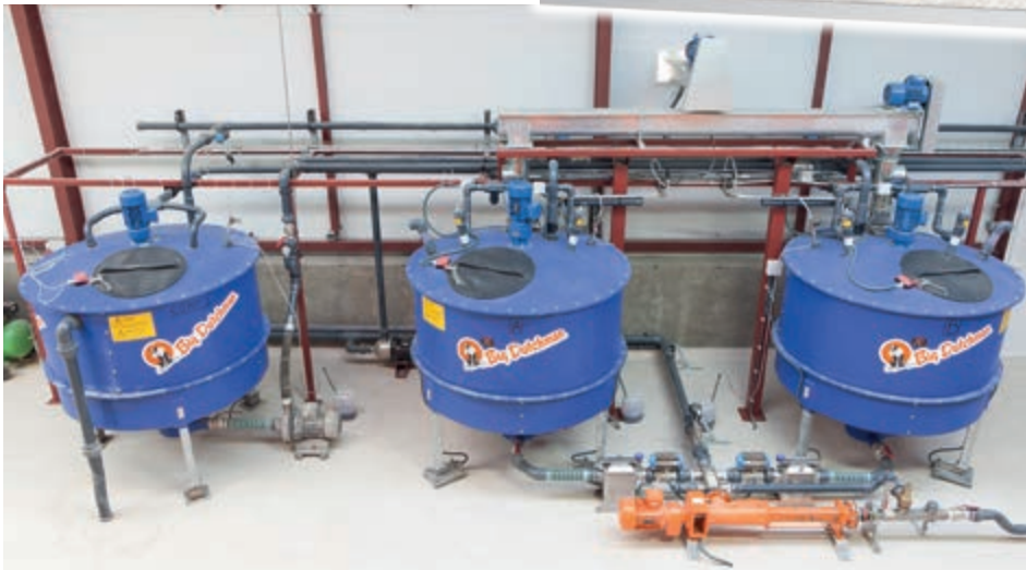
Futterküche: 2-Tank-Anlage mit Brauchwassertank
