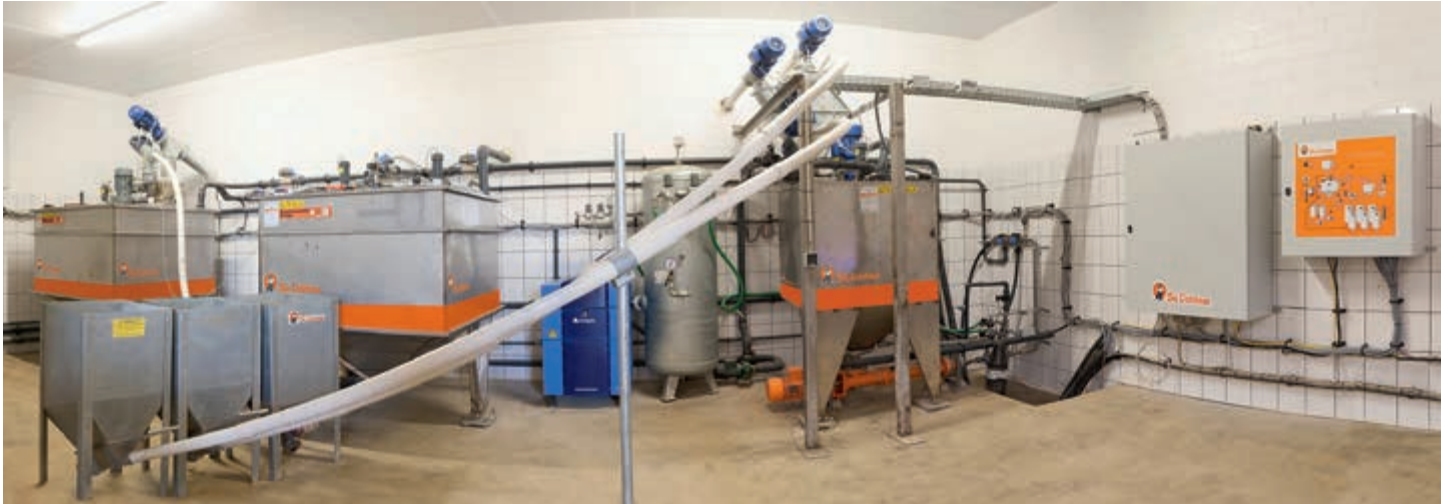
Blick in eine Futterküche mit einer druckluftbasierten HydroMix-Flüssigfütterung für den Ferkelaufzuchtstall und einer 1-Tank-Restlos-Anlage für den Sauenbereich
