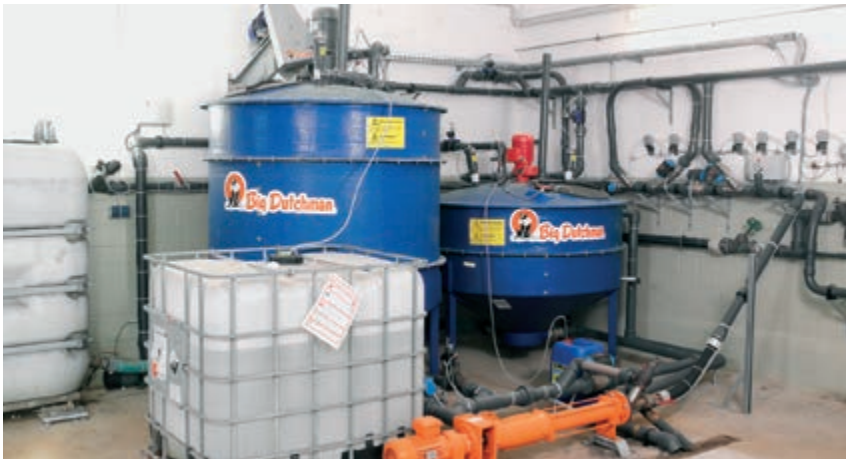
Futterküche: 1-Tank-Anlage mit gewogenem Brauchwassertank
