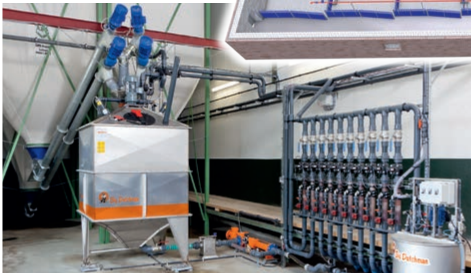
Futterküche: 1-Tank-Anlage mit gefüllten Stichen für einen 2000er Maststall
