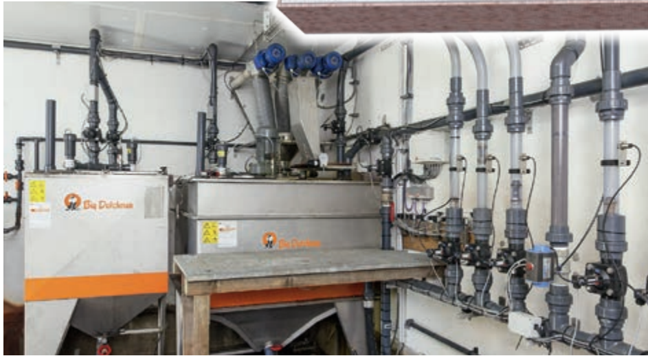
Futterküche: 1-Tank-Anlage mit Brauchwassertank und vier JET-Stichen
