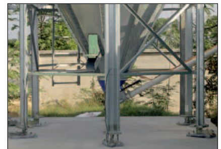
Silowiegung mit elektronischen Wiegestäben
